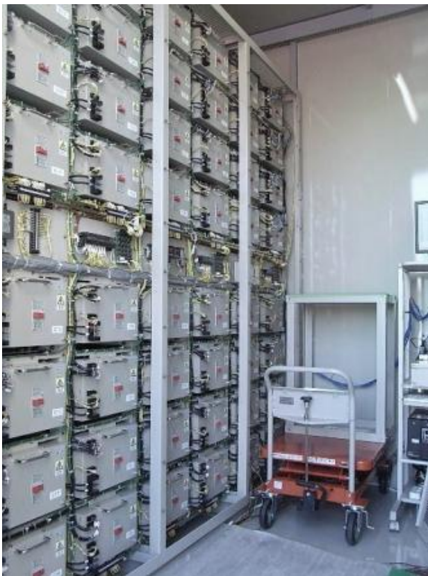
<リチウムイオンキャパシタ盤 (内部) >
